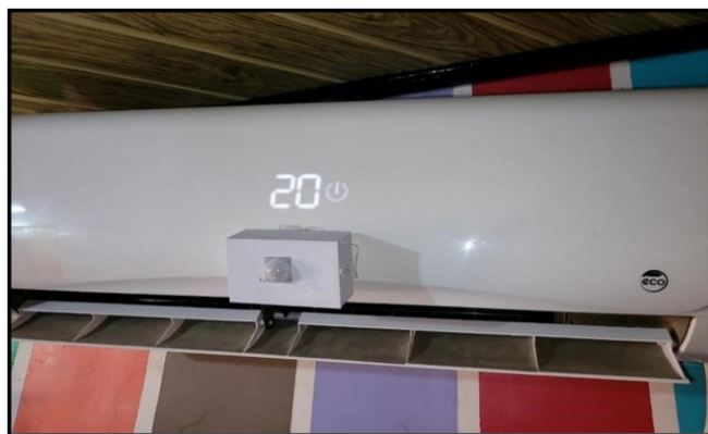
Figura 3: Protótipo instalado e em operação em um ar-condicionado
